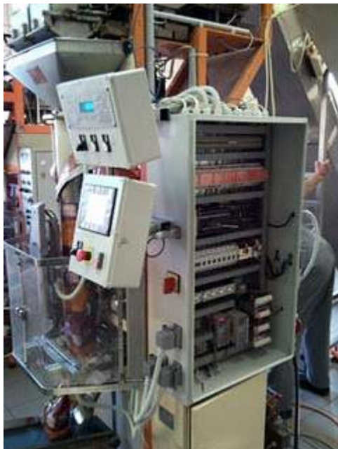
Felújított csomagológép vezérlés és kezelőpult
